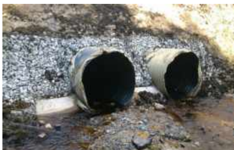
Рисунок 1 - Недопустимое состояние водопропускных труб
